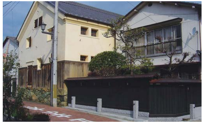
▲左の土蔵は、かつての木蠟倉庫を保全したものの、水害の歴史を物語る物件の一つで、商品を水害から守るために、石積みの上に土蔵が建築されている。右手の塀は、単なるブロック塀だったものを改修事業で改善したものの。
